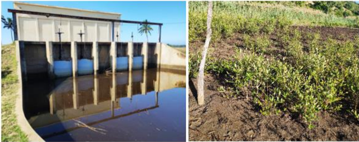
Foto 1. Dique com 5 comportas danificadas no canal Angluzane e plantação de mangais a jusante do dique (Fonte: O autor).
