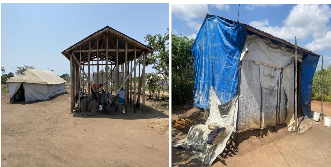
Figura 2: Casa construída pela CARE International. À esquerda, em Outubro de 2020. À direita, em Abril de 2023.
