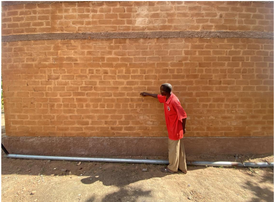
Figura 4: Casas construídas em Masquil alto 2, Guara-Guara, já com fissuras. Na foto de baixo, um beneficiário indica as fissuras na parede traseira da casa Fotos: U. Mandamule. Abril 2023.
